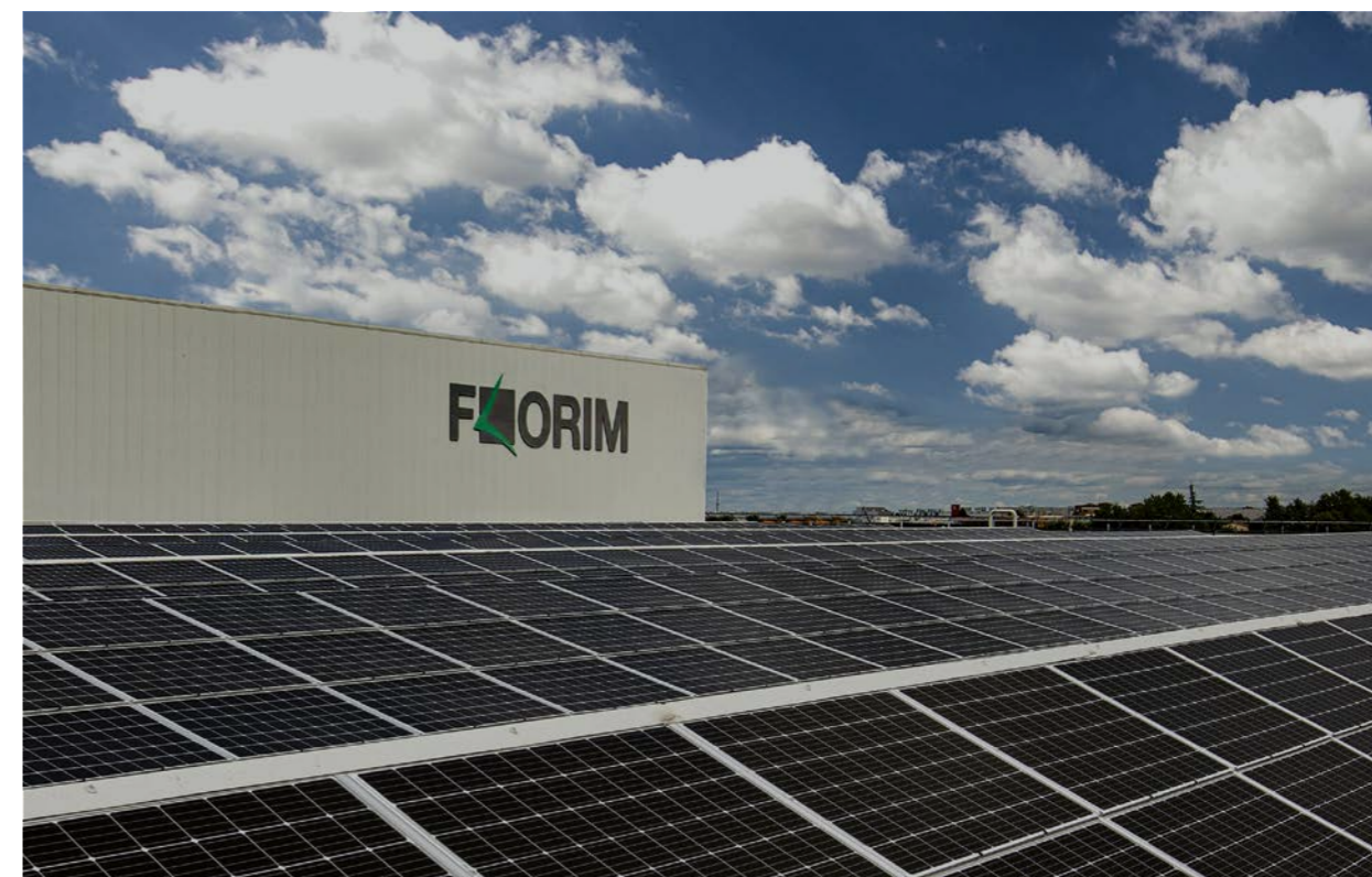
Vista aerea dei pannelli fotovoltaici della sede principale (Fiorano Modenese - MO - Italia)
