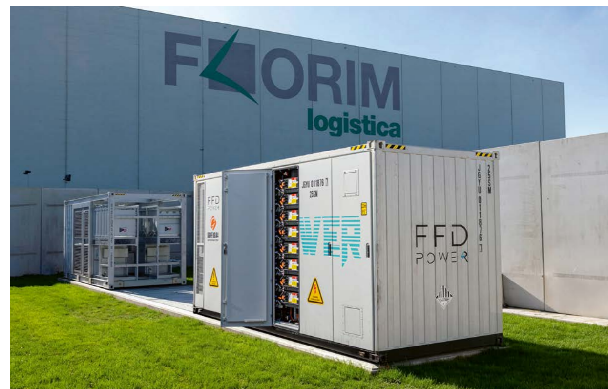
Batteria di accumulo BESS | Sede principale FLORIM (Fiorano Modenese - MO - Italia)
